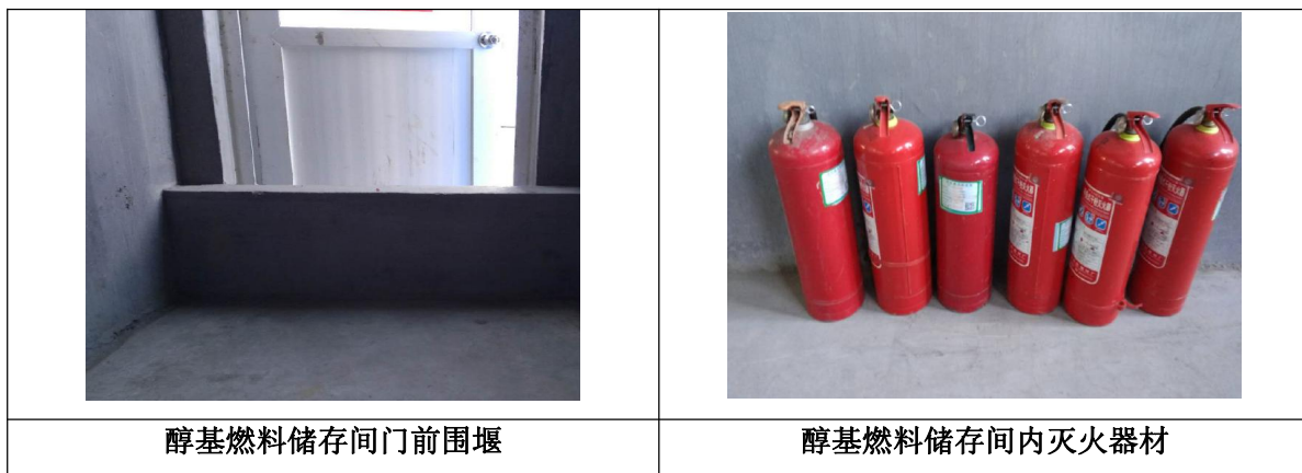
图 4-2 醇基燃料储存间环保防范措施
