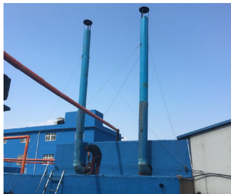
图 4-1 醇基燃料锅炉废气排气筒
